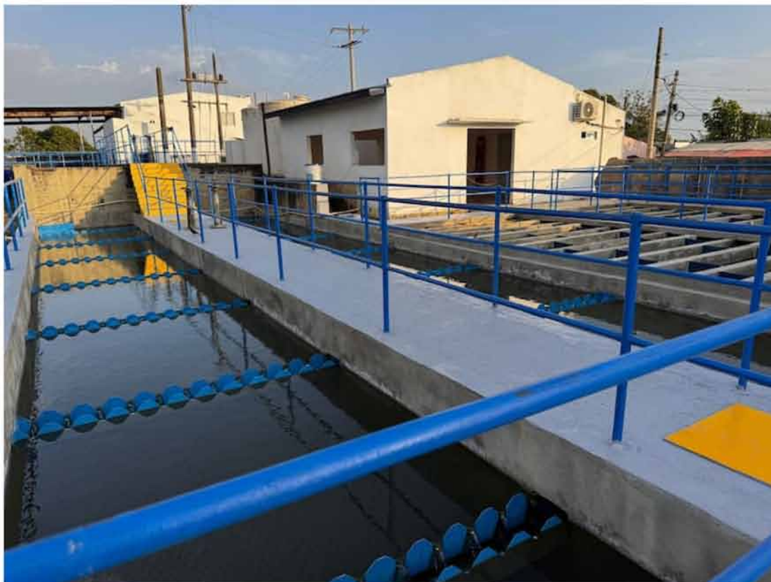
Planta de Tratamiento de Agua Potable, PTAP Lorica Regional Bajo Sinú.
